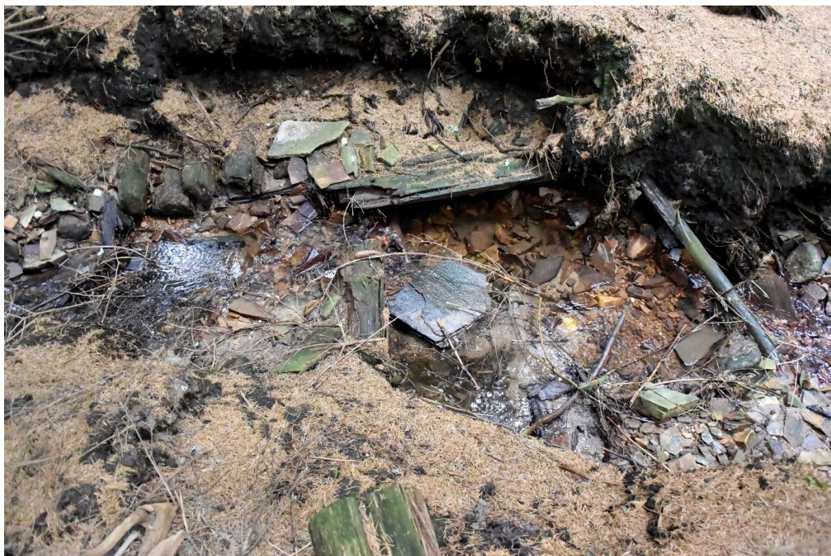
Obr. 23. Porušená dřevěná konstrukce vyčnívající z břehů Holcovského potoka v úseku pod hrází zaniklé vodní nádrže. Pohled z levého břehu. Foto Pavel Rous 2017.
